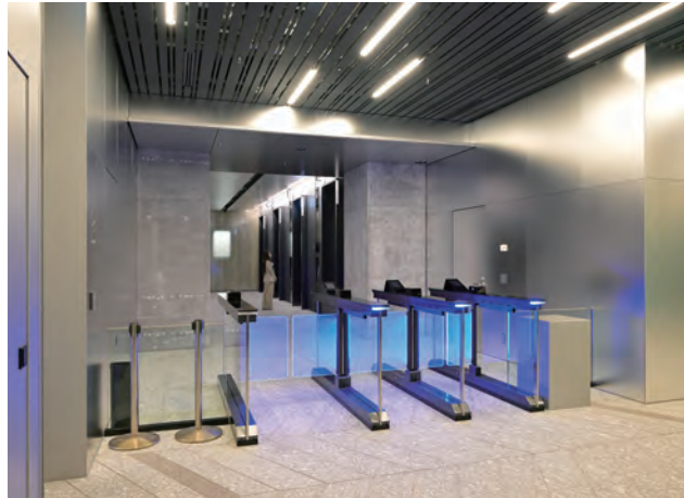
▲セキュリティゲートと連動したエレベーター先行予約システム「エレ・ナビ」を採用（3階エレベーター乗場）
