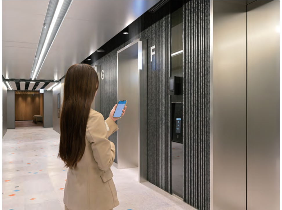
▲T-BuSS®のスマートフォンアプリでエレベーターの呼び登録・配車が可能（9階エレベーター乗場）
