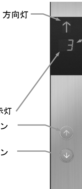
乗場ボタン及びインジケーター
